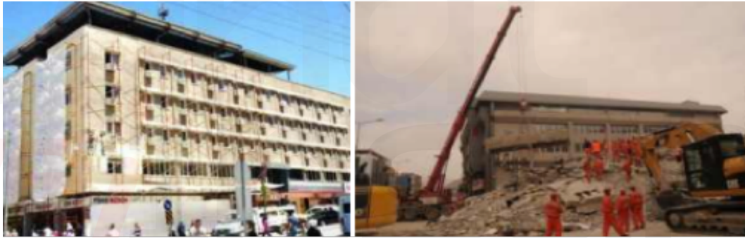
Görsel 25. İkinci Depremde yıkılan Bayram Oteli (a) Deprem Öncesi (b) Deprem Sonrası
