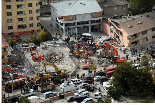
Görsel 24. Van Depremi ile Maraş Caddesinde Yıkılan Safa Apartmanı
